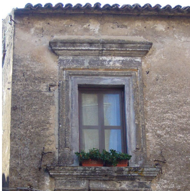
Figura 5. Casertavecchia, seminario vescovile (ora palazzo Mastrangelo), finestra al 1° piano sul lato sinistro della facciata su piazza Duomo.
